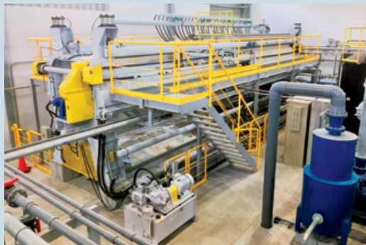
洗浄した灰を脱水するフィルタプレス
