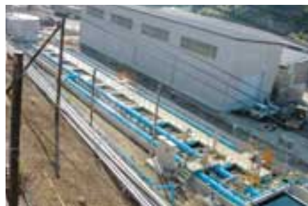
細倉鋳業(株)に新設された砂ろ過装置
